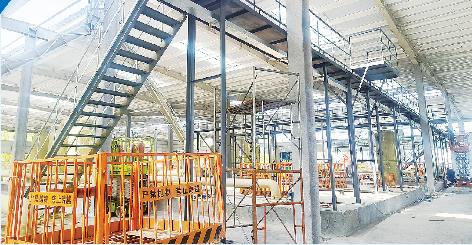
今年以来,临港开发区抢抓施工“黄金期”,加快推进项目建设。图为基本完工的周口海盛生物科技产业园项目厂房。
